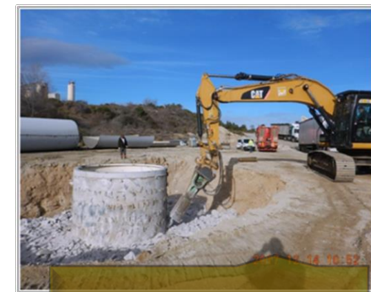
Destruction des fondations
